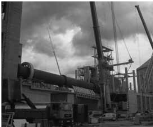
2. kép Forgókemence, mögötte a klinkerhűtő és a klinkersiló
