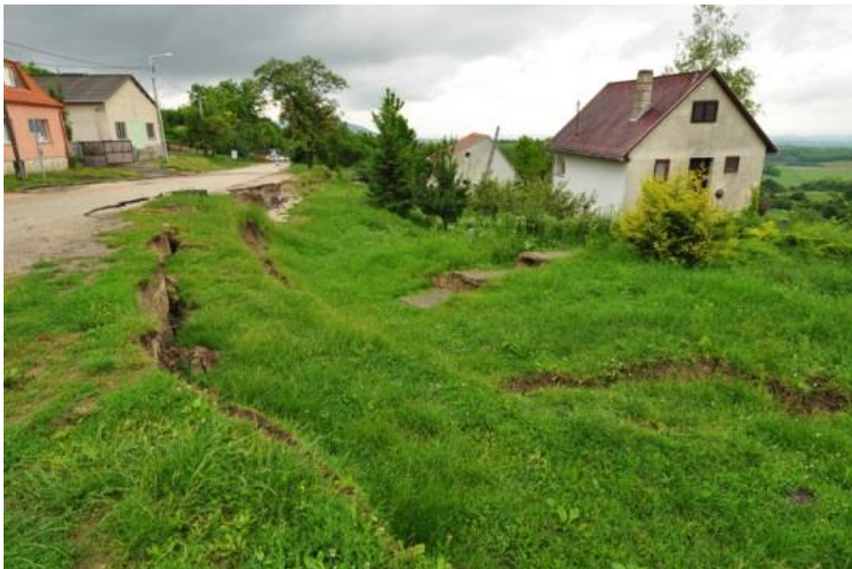
1. fotó: A 2010-es dunaszentmiklósi csuszamlás során több családi ház, pincék, vezetékek és közút is megrongálódott (Albert, 2013).
